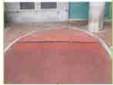
③ 바닥 균열
